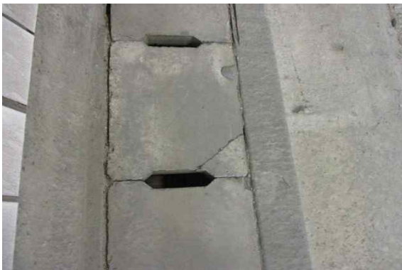
공동구 SPAN.11 덮개 파손
