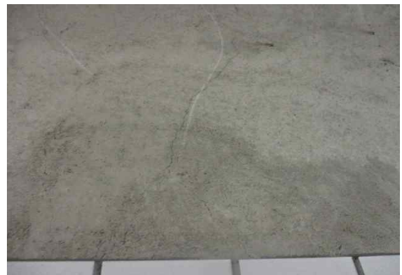
라이닝 SPAN.34 균열(0.3mm미만)
