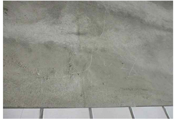
라이닝 SPAN.9 균열(0.3mm미만)
