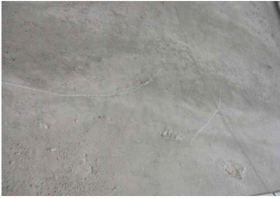
라이닝 SPAN.8 균열(0.3mm미만)
