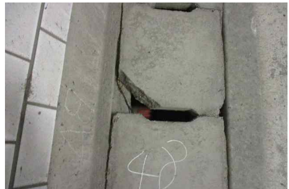
공동구 SPAN.48 덮개 파손
