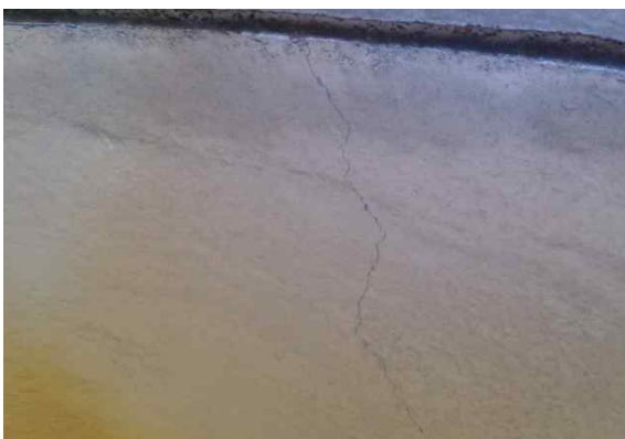
라이닝 SPAN.50 균열(0.3mm이상)
