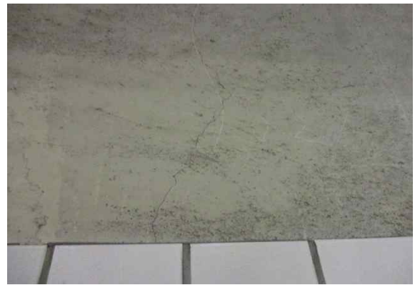
라이닝 SPAN.20 균열(0.3mm미만)
