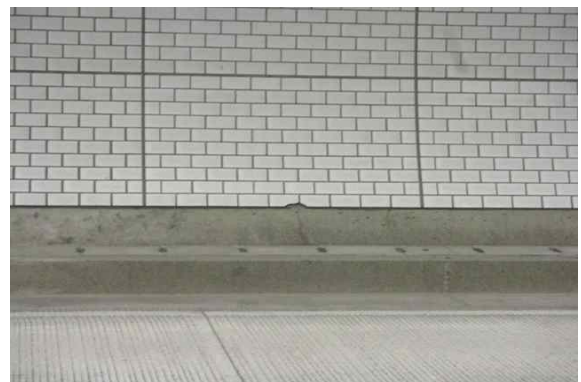
측벽부 SPAN.37 타일 파손
