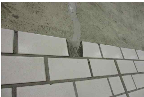
측벽부 SPAN.35 타일 파손
