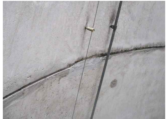
라이닝 SPAN.5 조인트부 파손 보수현황
