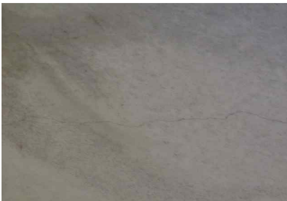
라이닝 SPAN.23 균열(0.3mm이상)
