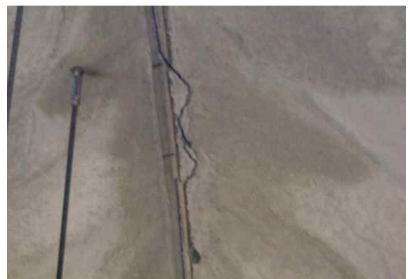
라이닝 SPAN.52 조인트부 들뜸
