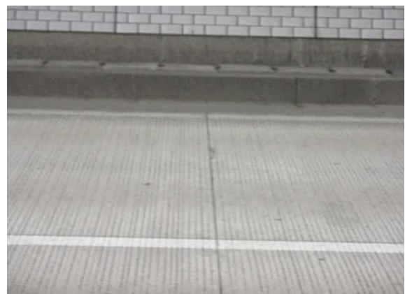
포장부 SPAN.27 파손
