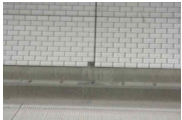
측벽부 SPAN.33 타일 파손
