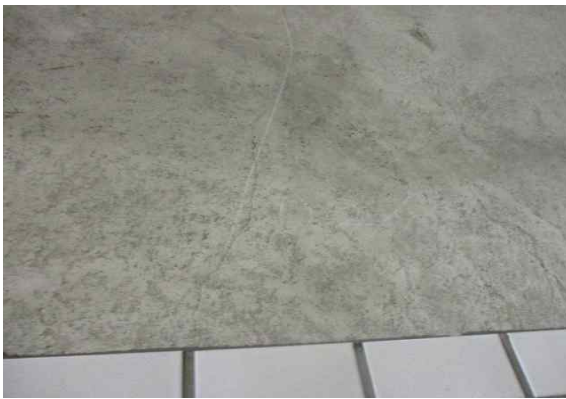
라이닝 SPAN.10 균열(0.3mm미만)
